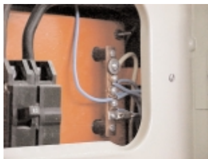
Fig. 10 - Detalhe do barramento de Neutro num quadro de Força
