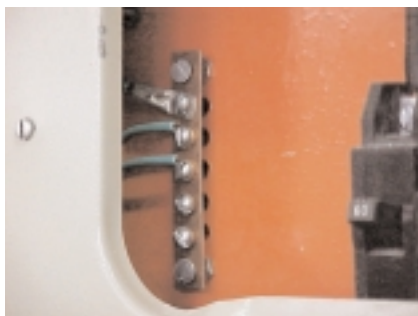
Fig. 9 - Detalhe do barramento de terra num quadro de Força
