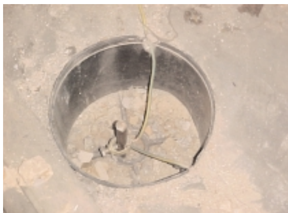
Fig. 6 - Detalhe de uma caixa de aterramento
